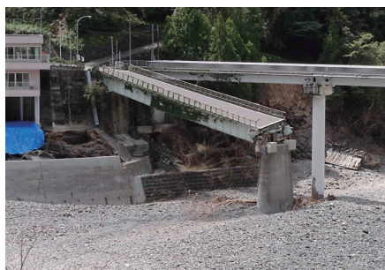
折立橋の落橋（奈良県十津川村） （P11）
