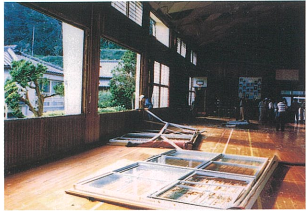
写真3 サッシが吹き飛ばされた体育館（鹿児島）
