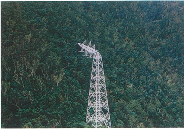
写真2 屈曲した送電線鉄塔
