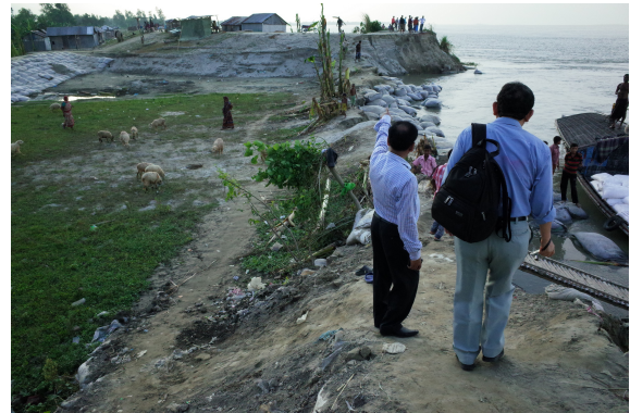
Fig. 8 Dyke breach site (Aug. 10 2014).
