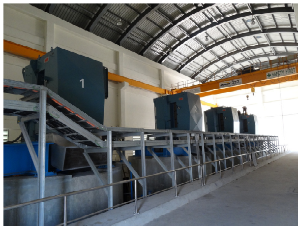
(c) 揚水用のポンプ
