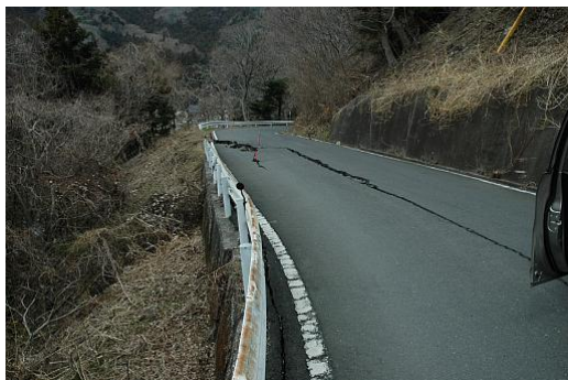
写真 21 道路盛土部での被害（県道2号石巻鮎川線）
