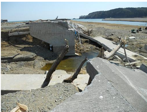
写真 4 小泉大橋（国道45号）左岸側橋台上流側の堤防決壊
