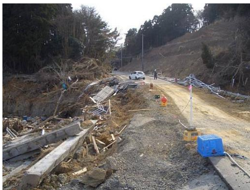
写真 13 道路盛土の津波被害（県道41号，石巻市鮫浦）
