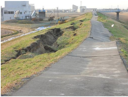
写真 2 新江合川堤防（右岸2.8～3.0km 付近）の被害
