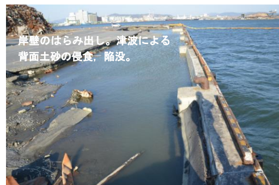
写真 10 石巻港中島埠頭岸壁南端部の陥没
