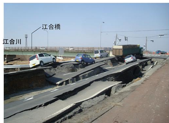
写真1 江合川左岸江合橋堤防被害(北上川下流河川事務所 地震災害情報第16報 6) )
