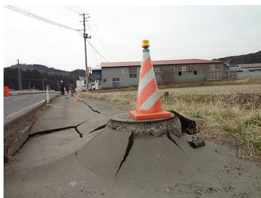
写真 29 マンホールの隆起と歩道の変状（遠田郡涌谷町猪岡短台）
