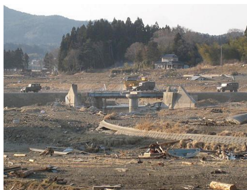
写真 18 国道45号の道路盛土、および気仙沼線沖ノ田川橋梁とその前後の鉄道盛土の津波による被害
