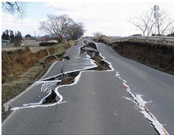
写真 5 迫川堤防（栗原市若柳字大林境前地内）の被害状況 8)
