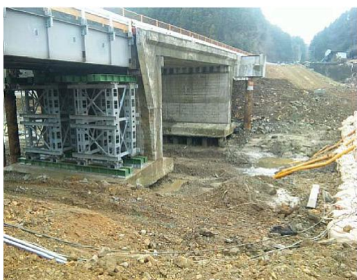
写真 27 二十一浜橋の津波による基礎周辺の洗掘と取付け部の流出 31)
