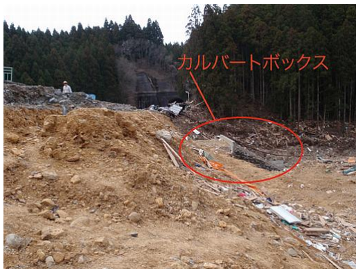
写真 15 盛土の北西側法面の洗掘・流出と軌道の流失（歌津駅南西側）
