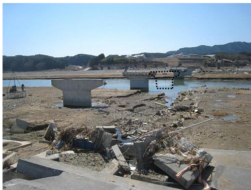
写真 25 小泉大橋の橋桁・橋脚の流出と橋脚周辺の洗掘（点線は流失前の橋脚位置）
