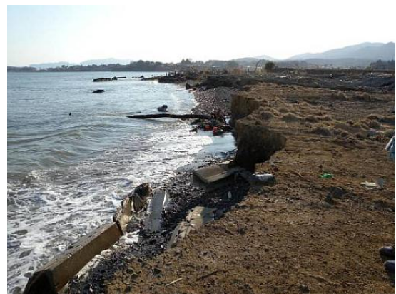
写真 6 杉ノ下海岸・御伊勢浜の海岸堤防の損傷と砂浜の流出
