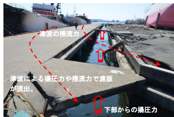
写真 9 気仙沼港の棧橋式岸壁の被災状況（渡版の流出）
