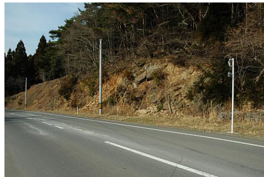
写真 24 道路切土斜面崩壊（県道2号，石巻鮎川線）
