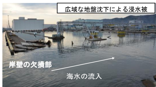
写真 11 石巻漁港東端部の海水流入の状況
