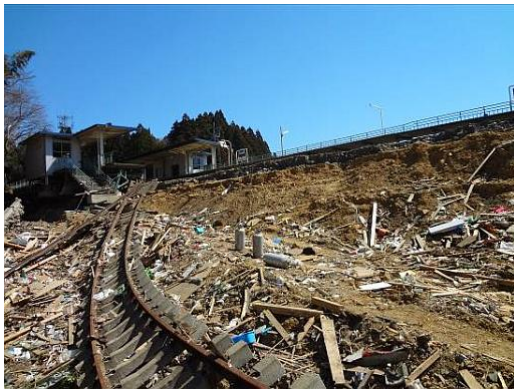
写真 14 盛土の北西側法面の洗掘と軌道の移動（歌津駅）
