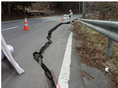
写真 20 谷埋め道路盛土変状（県道41号、女川町高白浜）
