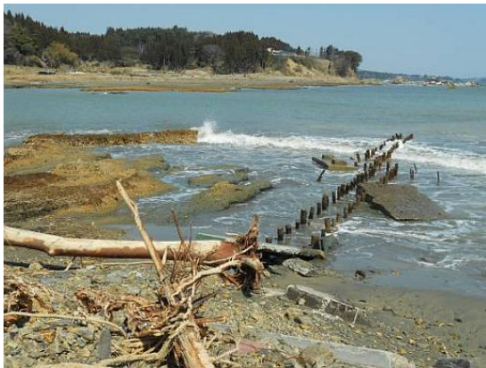
写真 8 中島海岸（小泉赤崎海岸）の砂浜流出と古い粘土質地盤の露出
