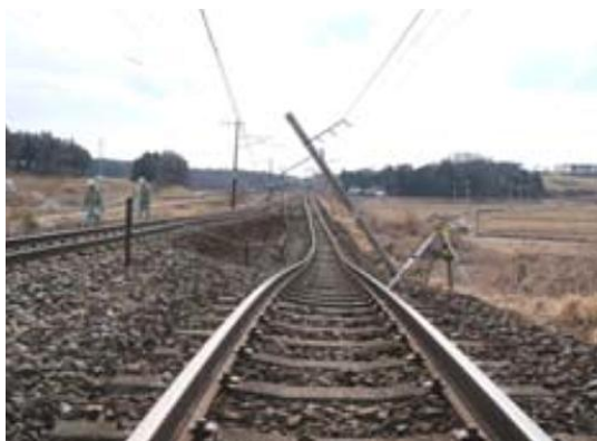
写真 22 盛土の崩壊（東北本線の梅ヶ沢～新田間：旧線が右側線、新線が左側線）
