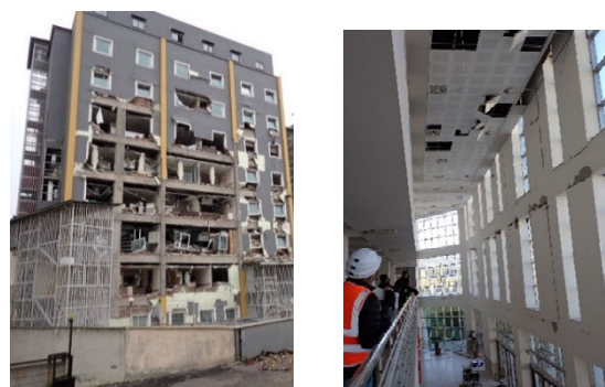
被災した病院の例（トルコ南部）
