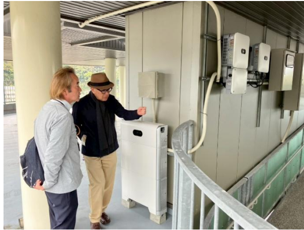
図 8 避難タワーに新設された蓄電装置(高知県黒潮町)
