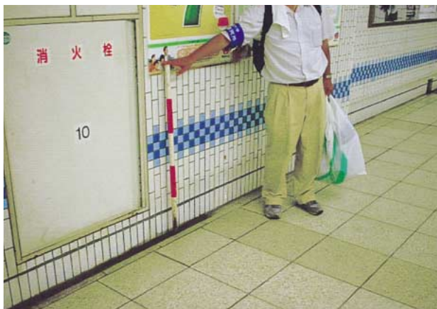
写真-4 地下鉄桜通線野並駅の浸水痕跡。約30cm。2000/09/13。
