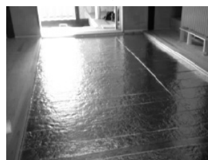
図6 畳下の真空断熱材
