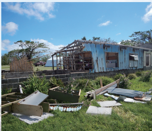
【写真2】全壊した校舎
