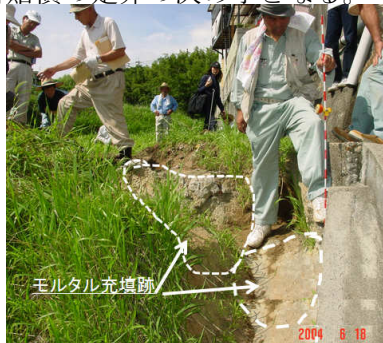
写真-1 モルタル充填跡
