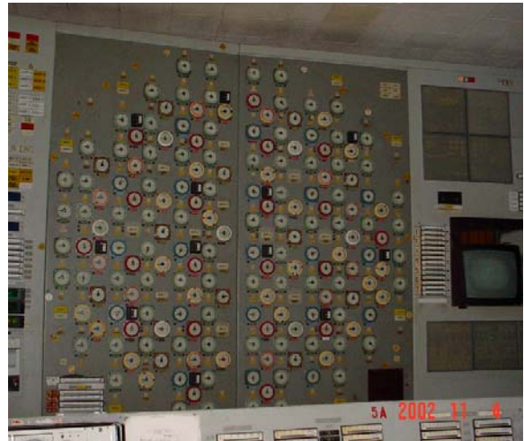
図10. 1号炉制御室の制御棒位置表示板
