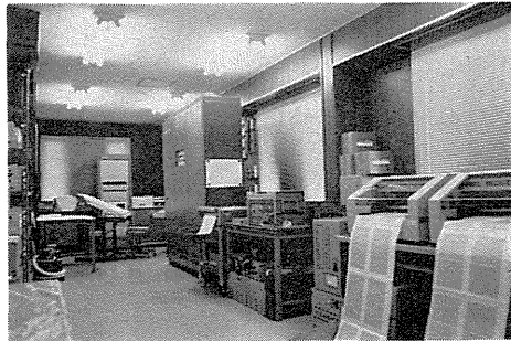
写真-2・22 テレメーター送受信室
