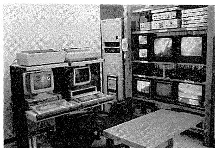
写真-2・38 砂防観測テレメータ・システム（観測室）
