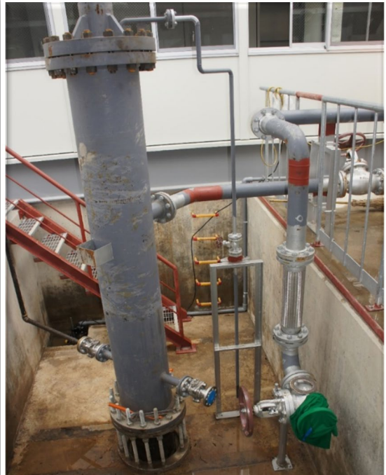
二重管型地中熱交換器 (地上部)
