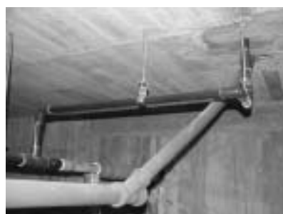
(右) 太陽館玄関横の配管の様子
