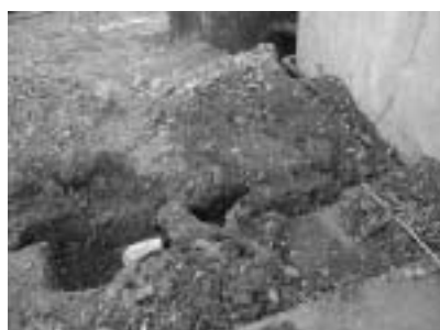
(左) 太陽館地下の配管の様子
