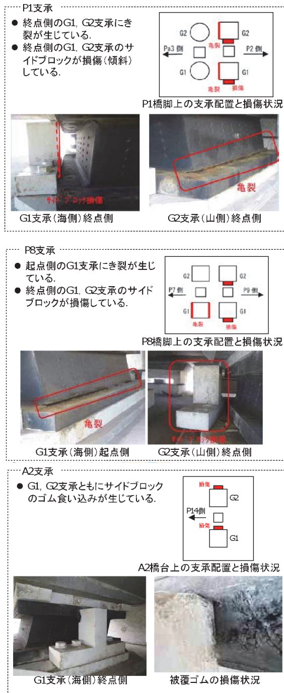
図-5 サイドブロックの損傷状況 5)
