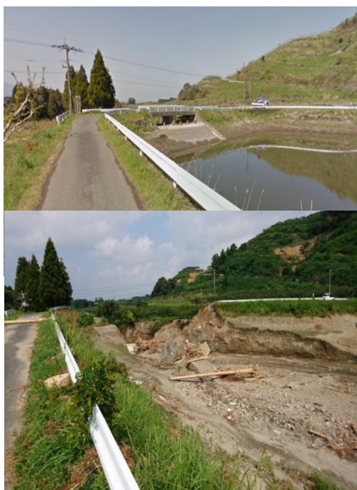
写真2 決壊した山の神ため池（奈良ヶ谷川） （上：決壊前（Google Earthより），下：決壊後）
