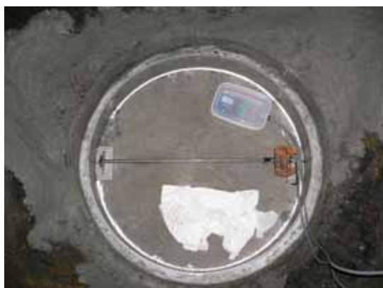
写真10：設置したひずみ計
