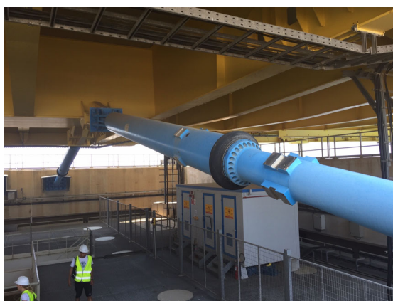
写真 1.15 Rion-Antirion Bridgeに設置された制振ダンパー
