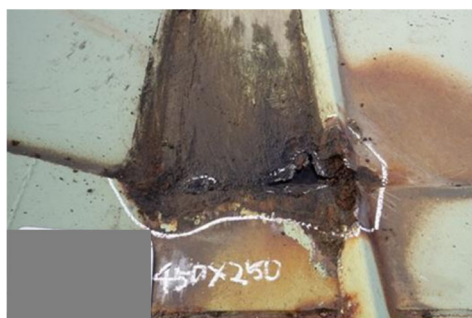
写真 5.1 主桁フェアリング部の腐食損傷事例[5-26]
