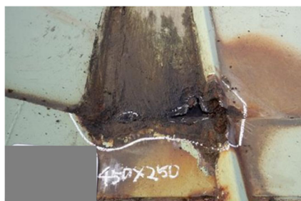
写真 1.11 フェアリングプレートの腐食損傷[1-71]
