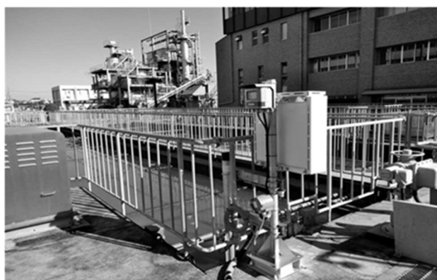
図 5-1 連続計測システム全景
