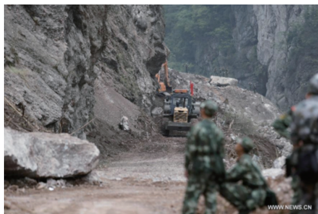
写真 2 雅安地震による道路法面の崩壊。このような崩壊が道路を寸断した（ www.news.cn ）。
